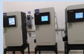
总排在线监测系统
