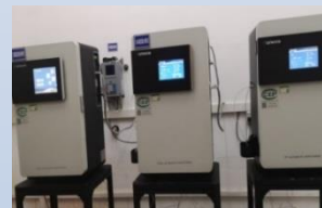
总排口在线监测系统
