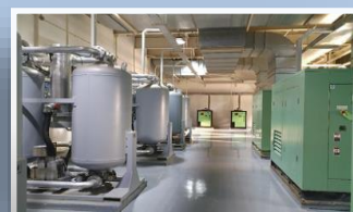
高噪设备独立站房
