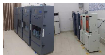
废水在线监测设备升级改造
